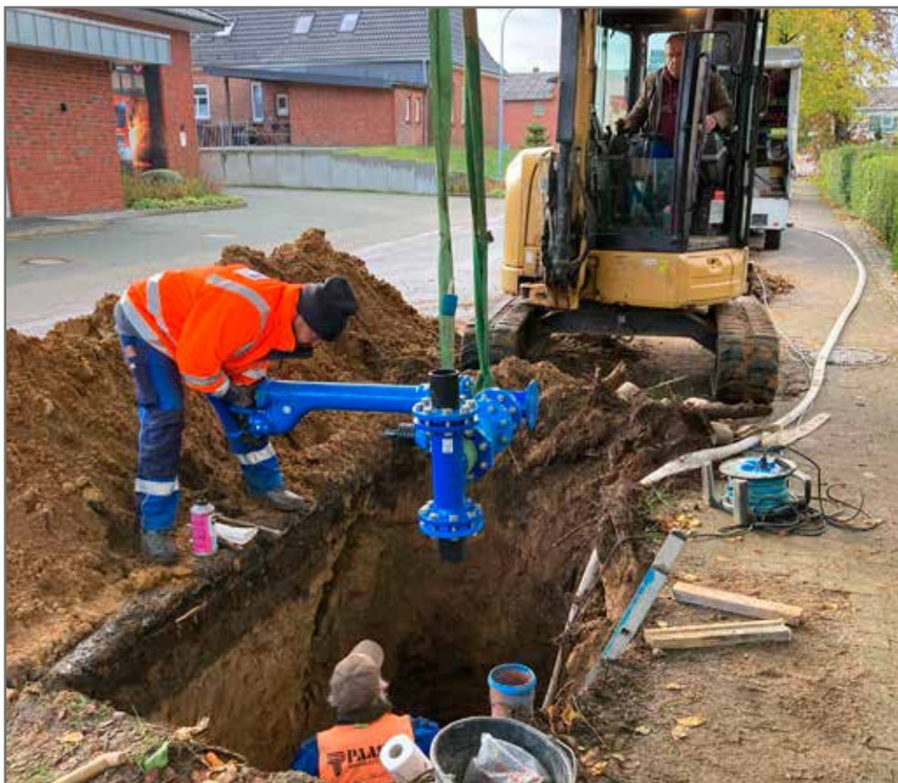
Königsberger Straße: Mitarbeiter der Firma Paasch installieren am 23. Oktober 2023 einen neuen Hydranten.
